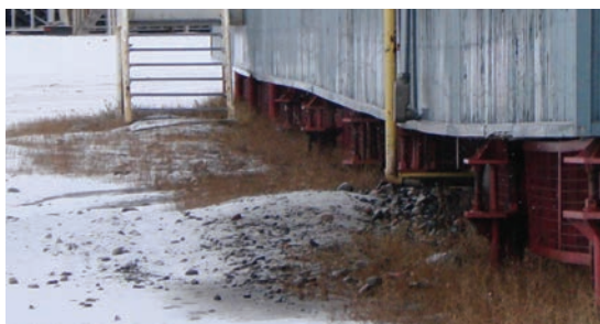
Un plancher à la surface irrégulière peut indiquer que le sol à l'extérieur n'est pas stable.
