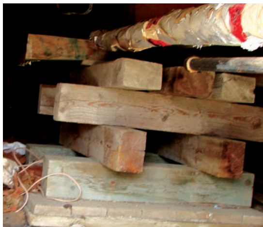
Dégradation du pergélisol agissant sur les fondations.
