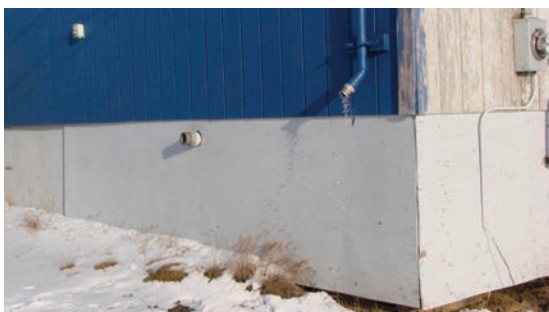
La présence de plinthes provoque la fonte du pergélisol en réchauffant l'espace sous votre maison en hiver.
