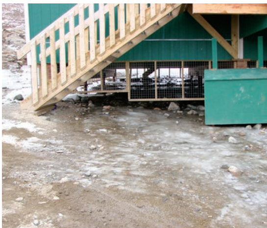
Il faut éviter que l'eau ou la glace ne s'accumule sous votre maison.
