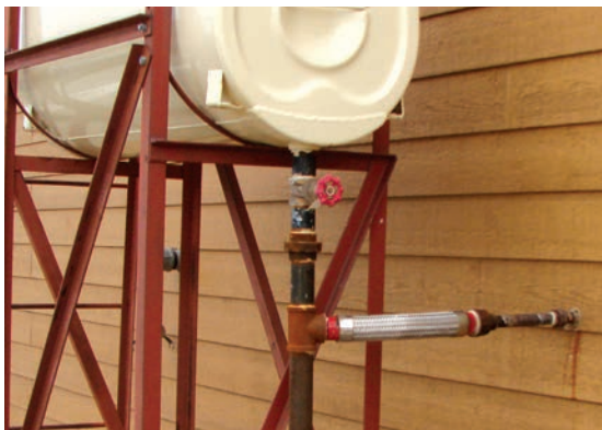
Le recours à un tuyau flexible contribue à éviter les bris de canalisation de mazout
